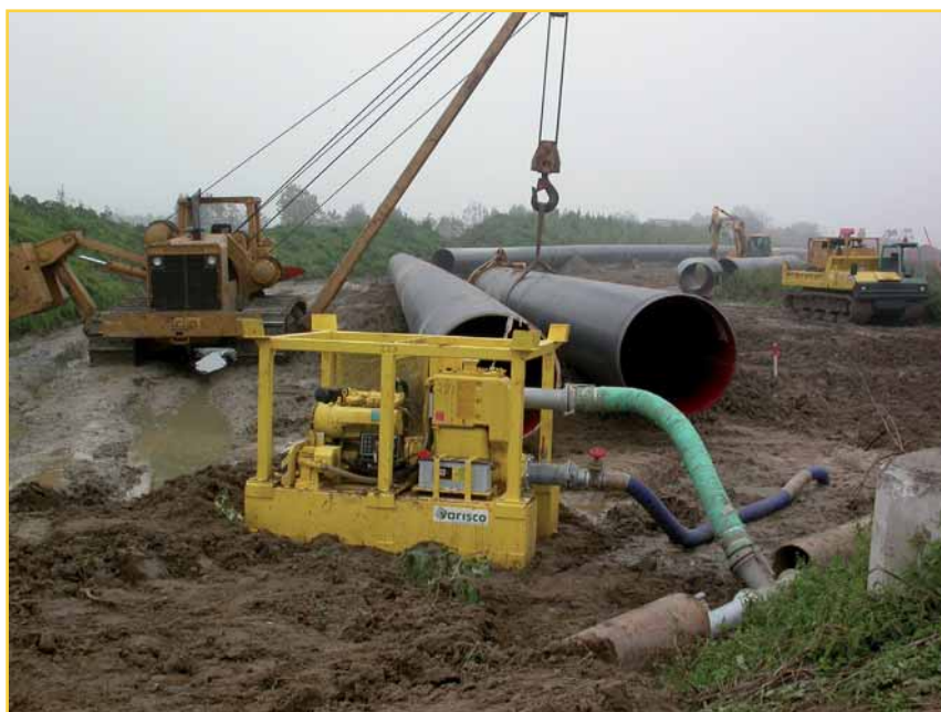
Drenaggio scavi per posa metanodotto Drainage excavation for pipeline installation Drenaje de las excavaciones para puesta metanoducto
