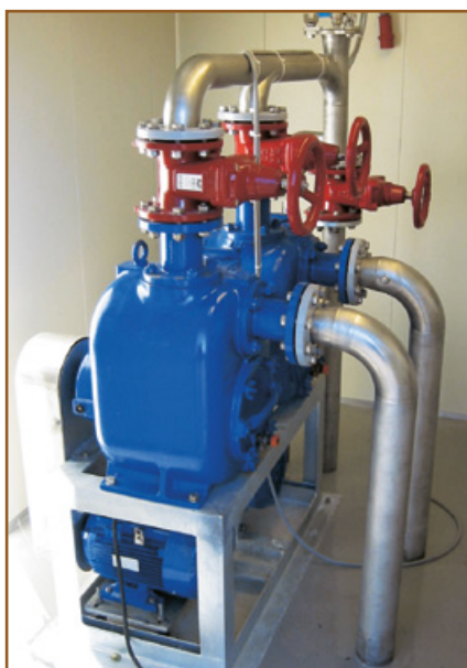
Stazione sollevamento fognatura Sewage lift station Estación de elevación del alcantarillado
